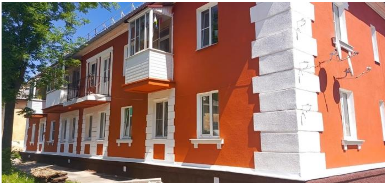
Фото 13 – г. Великие Луки, ул. Ставского, д. 8 (капитальный ремонт крыши, фасада, а также систем теплоснабжения и электроснабжения)
